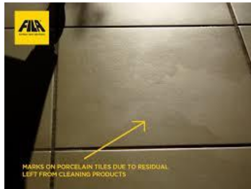
Imagen 105. Manchas en pisos cerámicos o porcelantos que no cumplen con la especificación de resistencia al manchado o por un uso inadecuado para el piso que no se tomó en cuenta al momento de seleccionarlos
