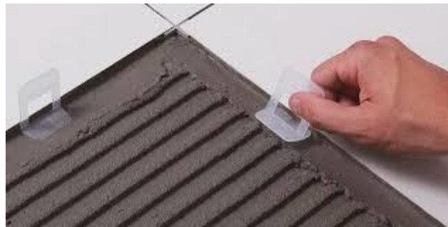
Imagen 104. Aplicación del método correcto, adhesivo, separadores y niveladores especiales para una instalación perfecta.
