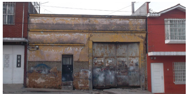
Figura 106: Construcción con daños y deterioro.
