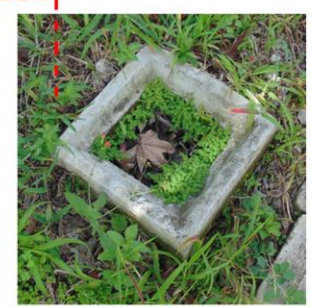
Caja de registro de drenaje sin tapadera, en apariencia no funciona.
