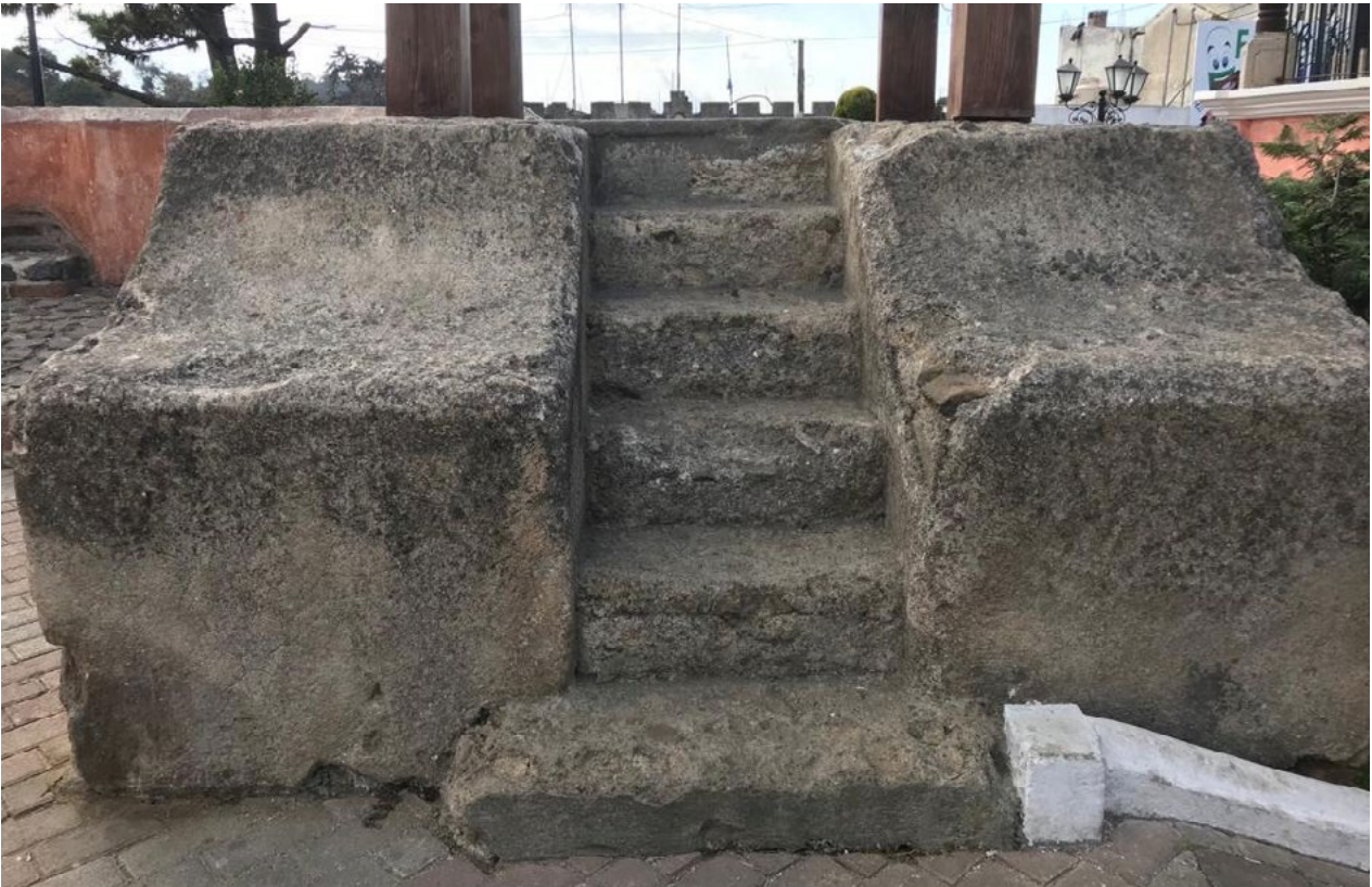
Fotografía 40. Base de piedra del monumento del antiguo campanario de Magdalena Milpas Altas. Fuente: Elaboración propia.
