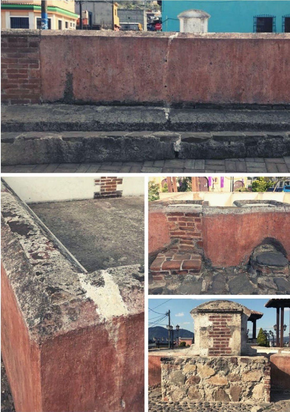
Fotografía 38. Detalles de la "restauración" realizada en 2014. La fotografía superior muestra los resanes en las grietas, la pintura aplicada, la reconstrucción de los muros con ladrillos. La de la izquierda muestra la calidad de los resanes con concreto convencional. La central muestra la reconstrucción de los muros con ladrillos y la diferencia de las gradas intervenidas no tan recientemente (existe la presencia de concreto) La de la esquina inferior derecha muestra la reconstrucción del muro con ladrillos. Fuente: Elaboración propia.
