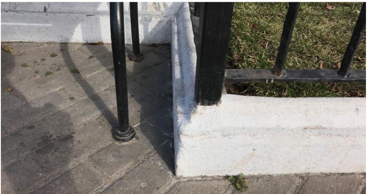
Fotografía 42. Bordillos afectados del parque central. La fotografía superior muestra una sección de bordillo reconstruido luego de haberlo removido. La inferior muestra un bordillo intacto desde su construcción en el 2014. Fuente: Elaboración propia.
