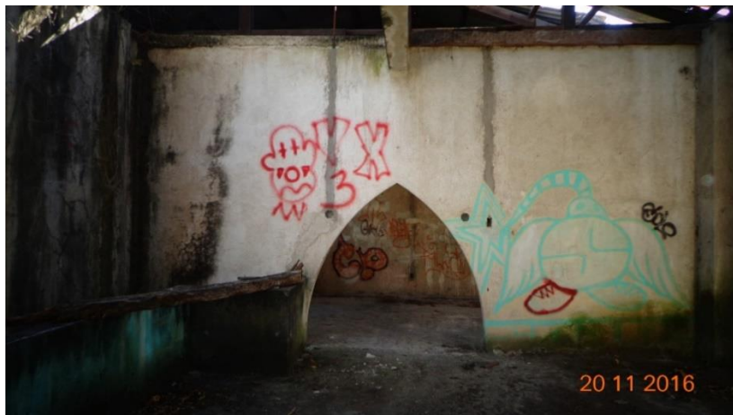
Figura 85. Muro con vano de puerta de arco ojival, que divide uno de los ambientes en la planta alta de edificio. Fuente: Velásquez Luna, 2016.
