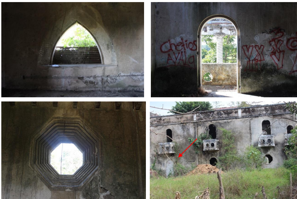
Figuras 94-95-96-97. Vista de vanos de puerta y ventanas que forman parte de la casa patronal en donde puede apreciarse los distintos estilos arquitectónicos que posee el inmueble. La flecha señala algunos de los vanos tapiados de la construcción. Fuente: Velásquez Luna, 2018.
