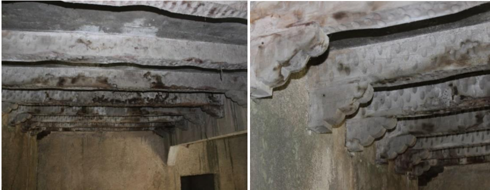
Figuras 88-89. Vista del entresuelo de concreto vertido sobre el artesanado de madera de pino tallado. Fuente: Velásquez Luna, 2018.
