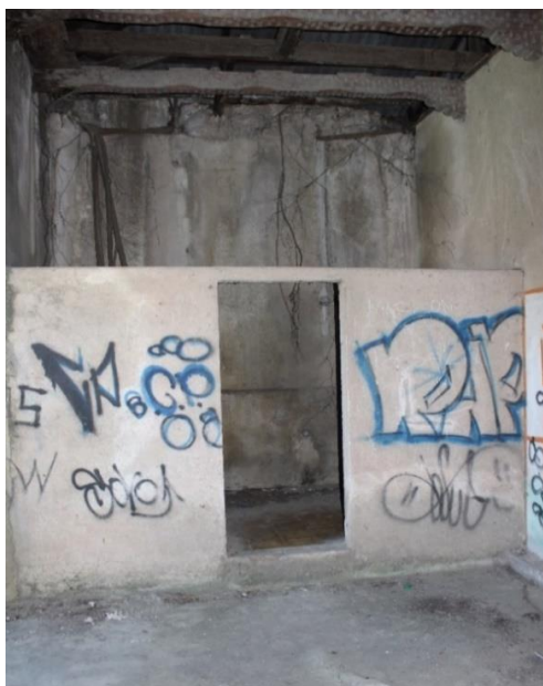
Figura 110. Vistas de los tabiques de block agregados que transforman el espacio original de la casa, y manchados por pintas y grafitis, algunos con pintura de aceite y aerosoles. Fuente: Velásquez Luna, 2018.
