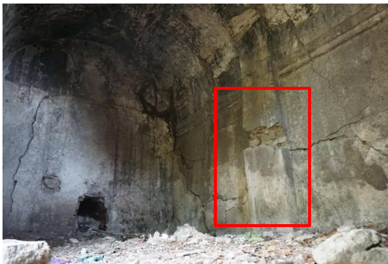
Figura 33. El área que aún se encuentra techada, corresponde posiblemente al ambiente de la sacristía, En la fotografía es posible observar las enormes grietas que afectan la estructura, así como parte del material colapsado. Fuente. Velásquez Luna, 2016.
