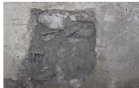
Figura 76. Oquedad en el muro que permite observar el cimienta a base de piedra. Fuente: Velásquez Luna, 2016.
