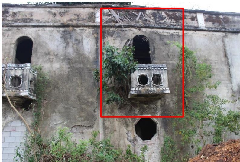
Figura 111. Se observan los daños que han sufrido los muros, disgregación de materiales por humedad y la presencia de microflora y macroflora. Fuente: Velásquez Luna, 2018.
