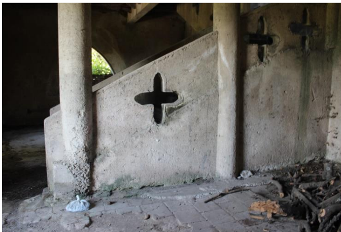
Figura 3. Interior de la casa patronal que evidencian algunos de los daños como la pérdida del piso y desprendimientos del revestimiento original.
