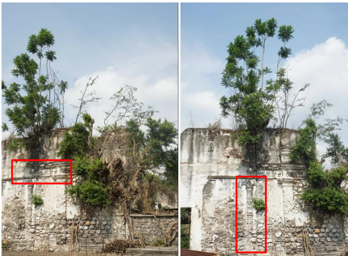
Figura 32. Vista de la fachada de la ermita en donde es posible algunos de los detalles decorativos en estucos, así como los daños causados por micro y macro flora en creciendo en sobre los muros. Fuente: Velásquez Luna, 2016.
