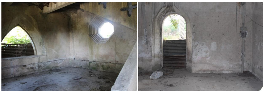
Figura 80-81. En la primera fotografía se pueden observar los gruesos de muros y los materiales constructivos a base de ladrillo de barro cocido, es evidente que el vano de ventana en forma de arco ojival es reciente pues se pueden observar varillas en los derrames. Fuente: Velásquez Luna, 2018
