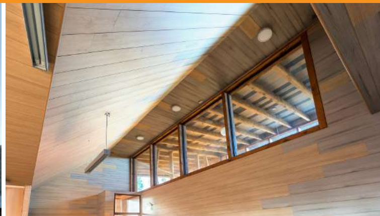
Figura 45. Ventanales en la parte superior de ambientes con permanencia prolongada, fotografía publicada por Plataforma Arquitectura, https://www.plataformaarquitectura.cl/cl/933525/escuela-rural-basica-cantino-taller-viga-maestra?ad_source=search&ad_medium=search_result_all
