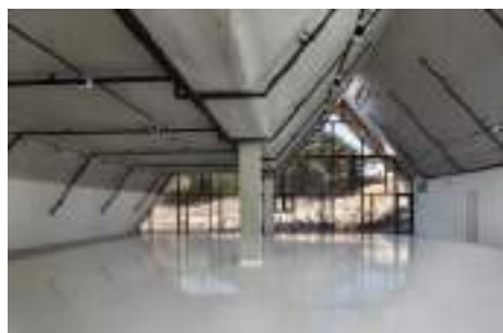
Figura 44. Instalaciones vistas - Design Strategy & Research Center. Fotografía de Yongkwan Kim (Plataforma Arquitectura, 2017)
