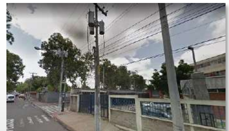
Figura 101. Acometida eléctrica en el CUM-USAC.
