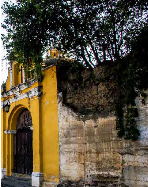
ILUSTRACIÓN 52 MURO DE ADOBE CON CRECIMIENTO DE FLORA Y PLANTAS SOBRE SU SUPERFICIE. SE ENCUENTRA ATACADO POR INSECTOS. FOTOGRAFÍA POR ALVARO SALVATIERRA, JULIO 2019
