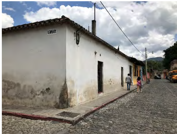
ILUSTRACIÓN 49 EFLORESCIENCIAS, ENCONCHAMIENTOS Y PERDIDA DE ACABADOS EN MUROS. FOTOGRAFÍA POR ALVARO SALVATIERRA, JULIO 2019
