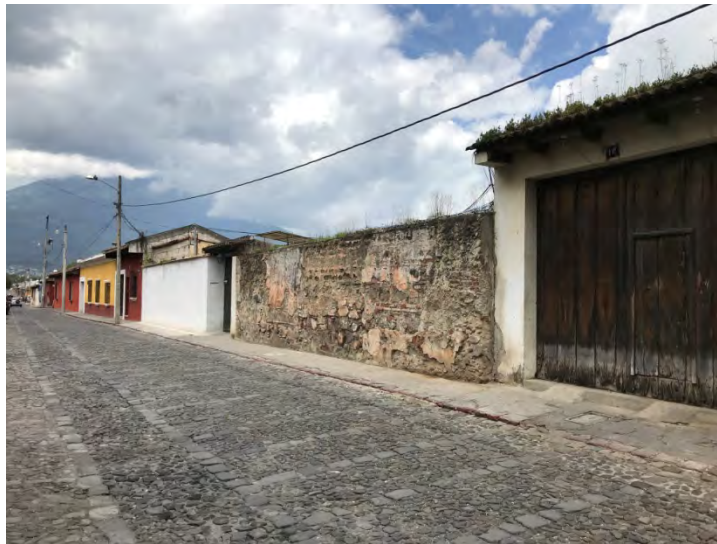
ILUSTRACIÓN 46 ESTADO ACTUAL DE UN MURO DE MAMPOSTERÍA SI ACABADOS. FOTOGRAFÍA POR ALVARO SALVATIERRA, JULIO 2019
