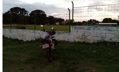
Figura 133. Cerramiento existen para el estadio municipal de Río Bravo, Suchitupéquez, en el se evidencia el deterioro por el uso. Fotografía propia, 2021
