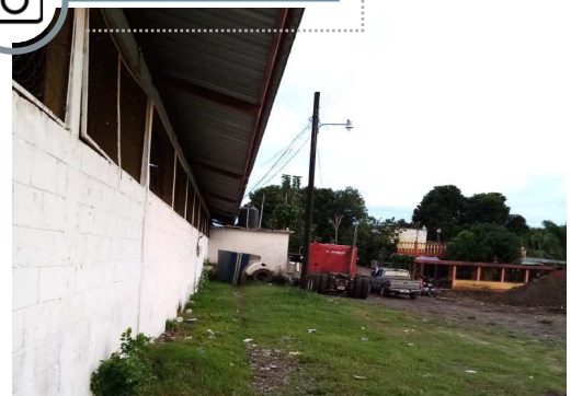
Figura 139. Salón Municipal de Rio Bravo, ventanas y paredes en mal estado. En los últimos años se repellaron las paredes de cerramiento, pero la estructura se encuentra en mal estado. Fotografía propia, 2021
