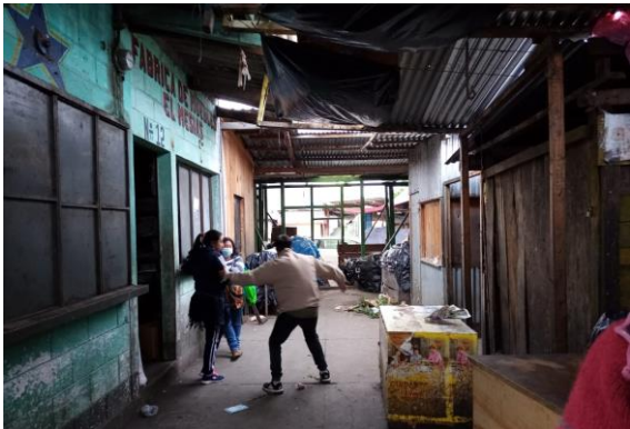
Foto No.9: Fuente propia En la fotografía se observa el techo de las instalaciones a punto de caer
