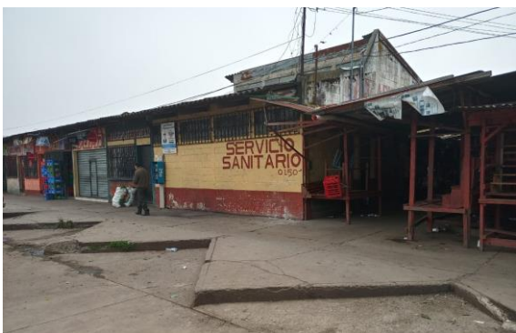
Foto No. 11: Fuente propia En la fotografía, ingreso a la batería de servicios sanitarios obstruida por puestos venta.
