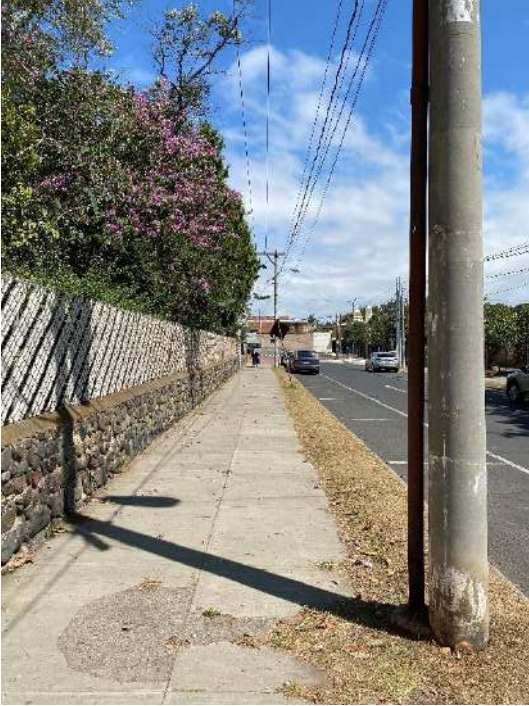
Figura 119. No.2 Estado actual de aceras sobre 20 avenida. Fuente propia.
