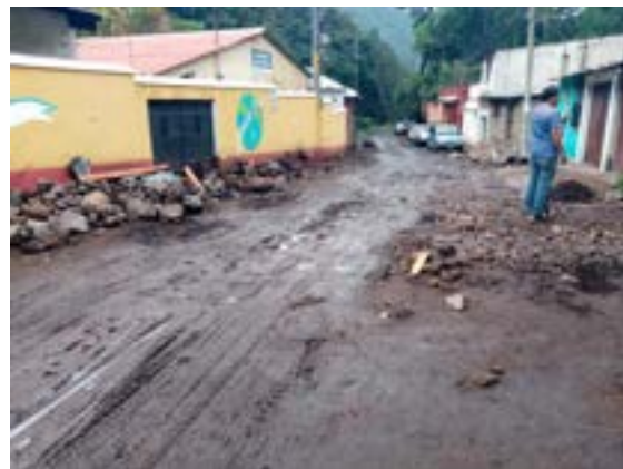
Figura 36. Daños causados en la avenida principal de San Juan Gascón por las lluvias Fuente: Elaboración propia
