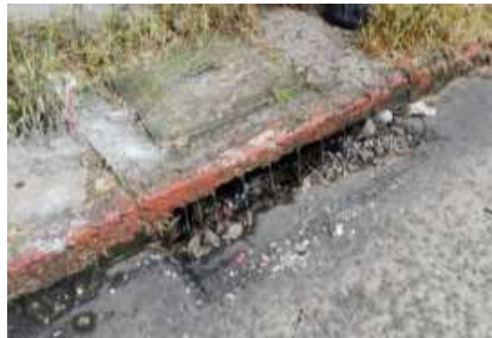
Imagen 65. Alcantarillado pluvial, zona 1, Coatepeque. Descripción: Se observa acumulación de residuos de basura generada en tiempos de lluvia. Fuente: Fotografía propia año 2020.
