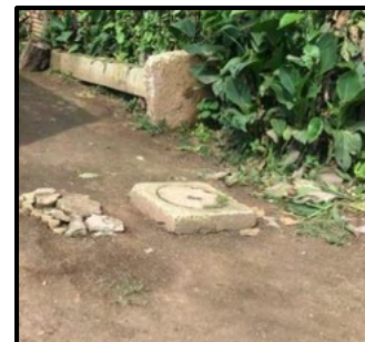
Figura 113 – [Servicio de alcantarillado municipal].
