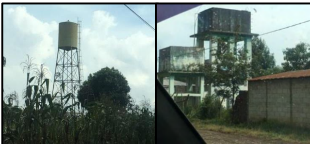
Figura 115 – [Tanques de agua potable elevados que suministran a la colonia].
