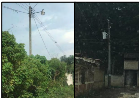
Figura 114 – [Postes de alumbrado público y servicio eléctrico].
