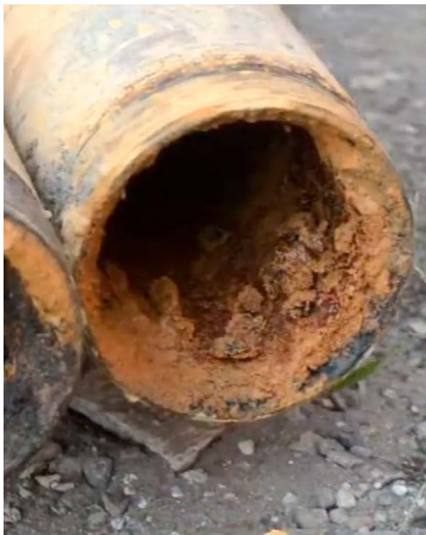
FIGURA NO. 113: Uno de los tubos que conforman el sistema de agua potable en el municipio de La Gomera con sedimento en su superficie interior. Fotografía por la Municipalidad de La Gomera, Escuintla, 2020.
