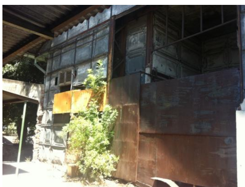
Figura 96. Almacén de Medicamentos, se han sustituido los paneles troquelados, por trozos de madera, lámina lisa y ladrillo de barro. Fuente: Elaboración propia. Año 2013.
