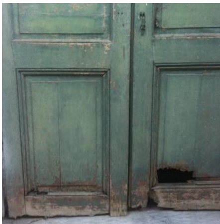
Figura 81. Desintegración de madera en puertas por humedad. Fuente: Elaboración propia.
