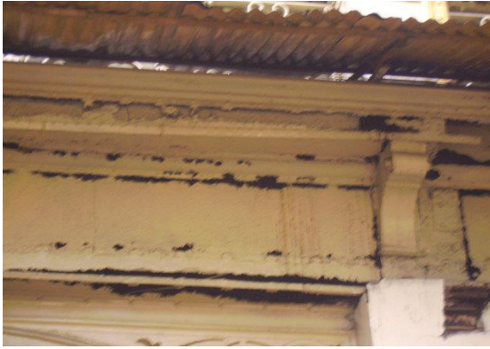
Figura 77. Corrosión en ornamentos metálicos de fachada en Edificio Administrativo. Fuente: Elaboración propia. 2017.
