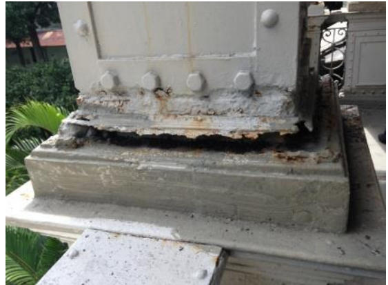
Figura 78. Desintegración en base de pedestal en terraza de Edificio Administrativo. Fuente: Elaboración propia. 2017.
