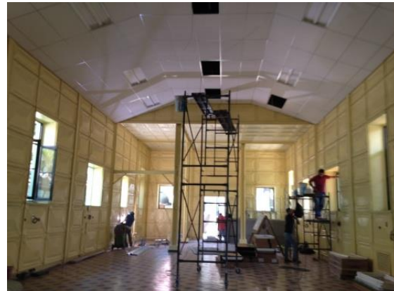
Figura 65. En la mayor parte de edificaciones el Cielo Falso de madera ha sido sustituido por losetas de fibrocemento apoyadas en perfilería metálica.
