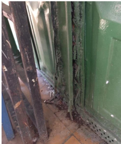
Figura 79. Desgarre laminar en estructura de paredes de Farmacia. Fuente: Elaboración propia. Año 2015.
