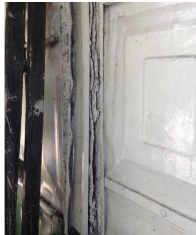
Figura 80. Otro caso de desgarre laminar en estructura de paredes de Farmacia. Elaboracion propia. Año 2015.
