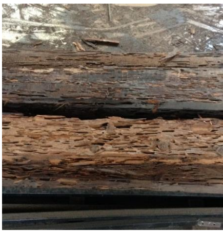
Figuras 82 y 83. Desintegración de elementos de madera causada por plagas: izquierda viga de soporte del cielo falso, derecha marco de puerta. Fuente: Elaboración propia. Año 2015.
