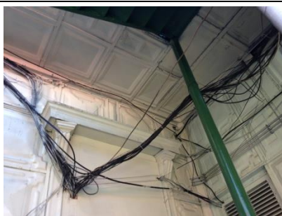
Pared Oeste, puerta sellada, instalaciones telefónicas sobrepuestas
