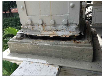
B. Corrosión en elementos de hierro
