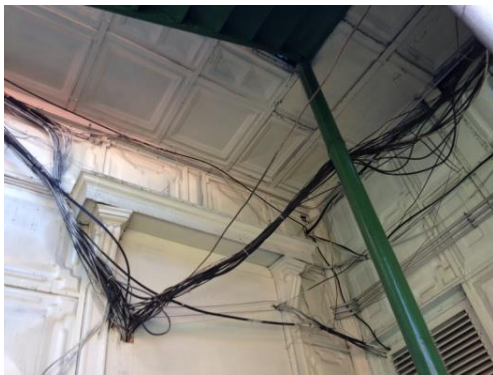
Figura 92. Sellado de hueco de puerta con plywood e instalación desordenada de cables de telefonía. Fuente: Elaboración propia. Año 2013.
