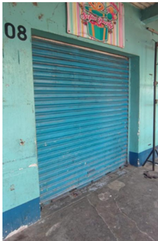
Ilustración 1: infraestructura deteriorada Fuente: fotografía propia
