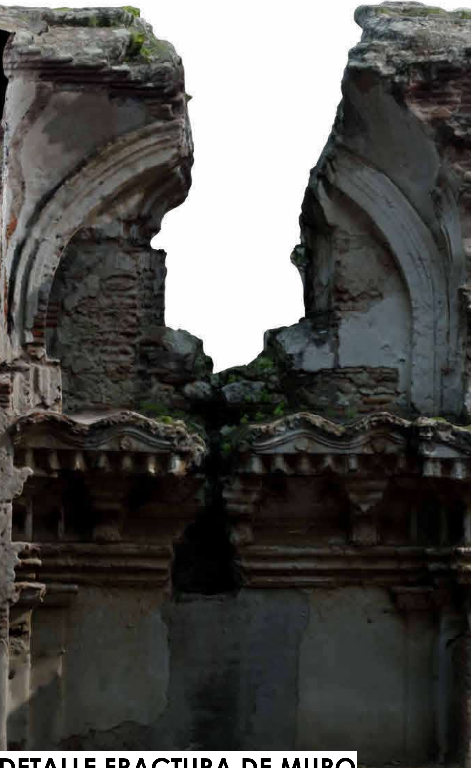
DETALLE FRACTURA DE MURO 1:35
