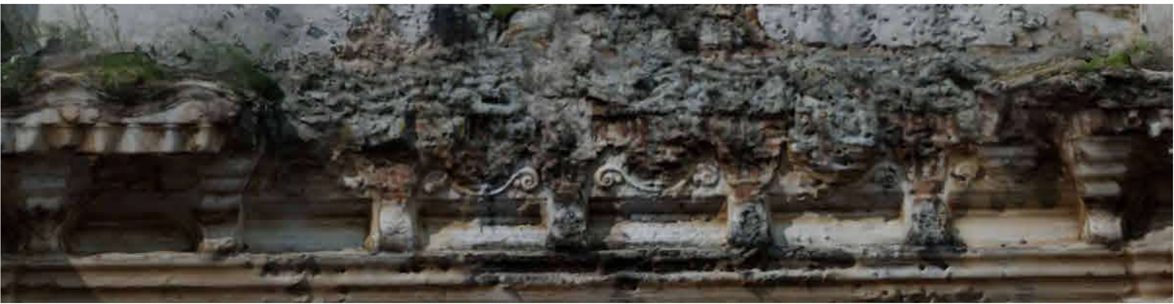
DETALLE ESTUCOS Y SEGREGACION DEL MATERIAL 1:25
