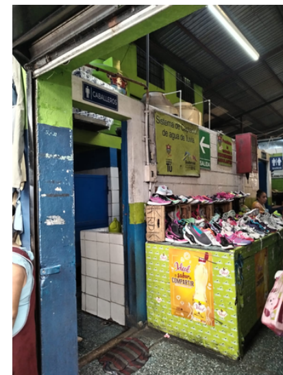
Imagen 94: Servicios Sanitarios del mercado en malas condiciones y no cumplen con el estándar y capacidad de personas del mercado.
