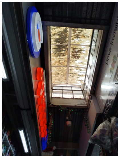
Imagen 93: Pozos de luz dentro del mercado no tienen las dimensiones correctas para brindar iluminación adecuada.
