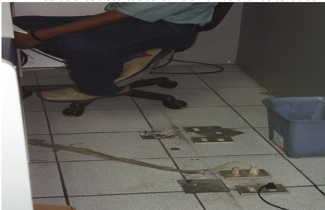
Ilustración No. 6 Instalaciones eléctricas del edificio 2 en las oficinas centrales
