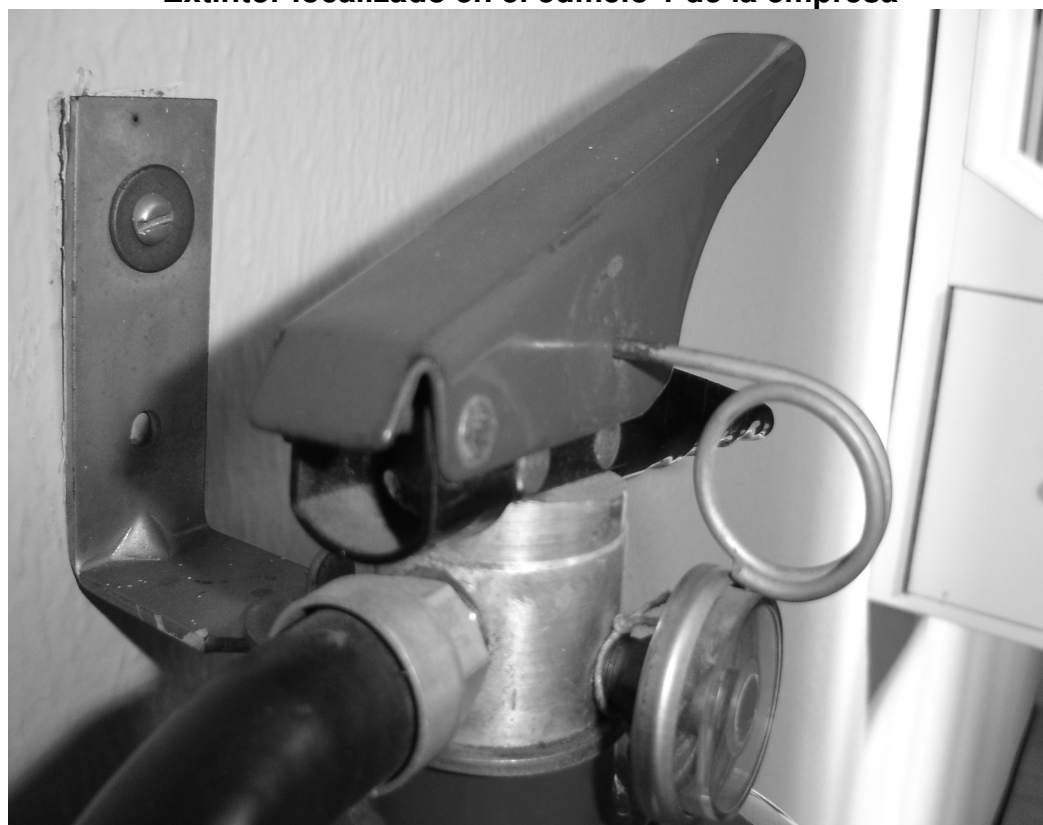
Ilustración No. 18 Extintor localizado en el edificio 1 de la empresa
