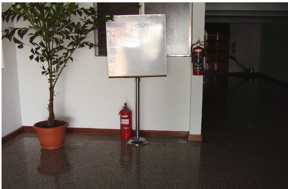
Ilustración No. 17 La ubicación y señalización de los extintores del edificio 5 Empresa Línea Aérea
