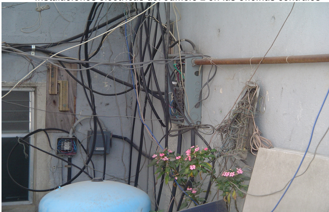
Ilustración No. 5 Instalaciones eléctricas del edificio 2 en las oficinas centrales
