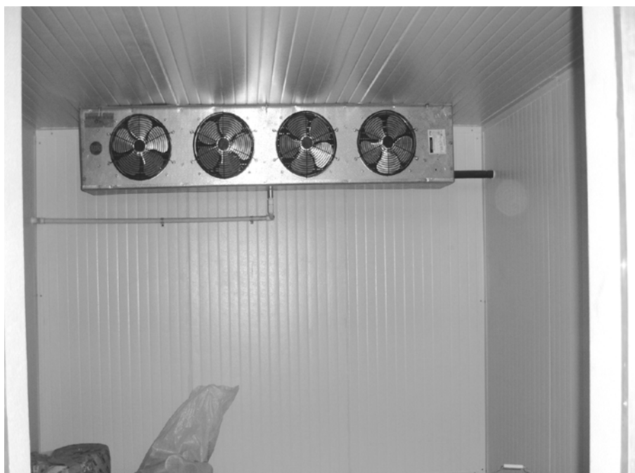
F. MÁQUINA REFRIGERANTE VISTA INTERIOR
