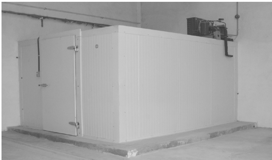
E. MÁQUINA REFRIGERANTE VISTA EXTERIOR
