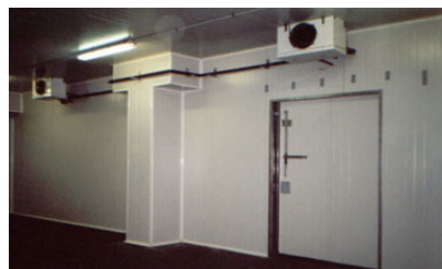
Vista de exterior del cuarto frío.
