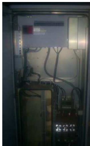
Gabinete de Energía
