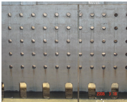
Figura 6. Fotografía de pantalla perforada hacia los sedimentadores ubicados en la planta de tratamiento de agua Lo de Coy
