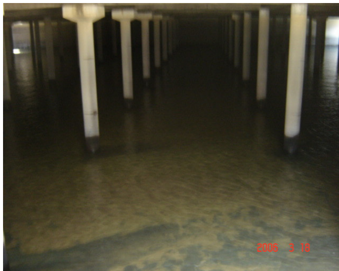
Figura 7. Fotografía de tanque de almacenamiento de agua tratada ubicado en planta de tratamiento de agua Lo de Coy
