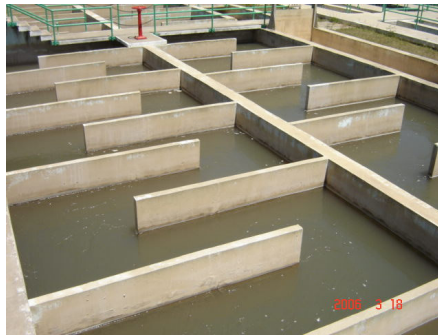
Figura 5. Fotografía de floculadores ubicados en planta de tratamiento de agua Lo de Coy
