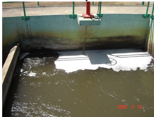
Figura 4. Fotografía de caja de entrada ubicada en planta de tratamiento de agua Lo de Coy
