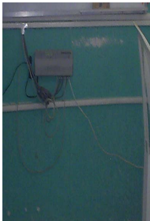
Imagen 19 Instalación Eléctrica - Laboratorio
