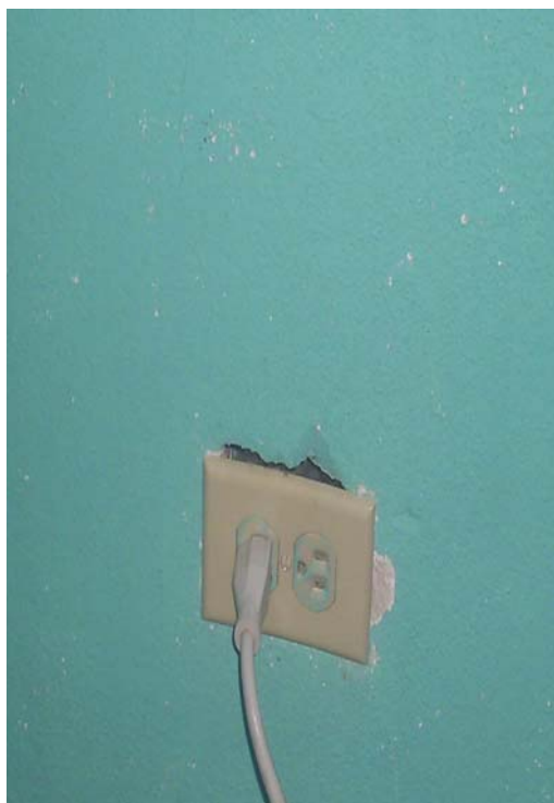
Imagen 18 Instalación Eléctrica – Salón de Clase
