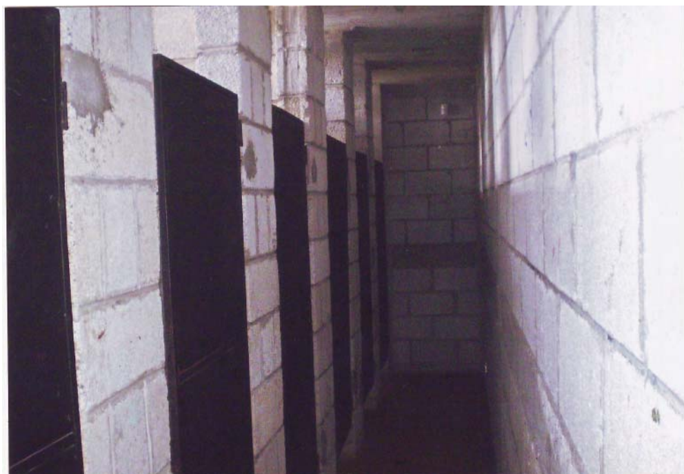
Fotografía 16 Sanitarios vista interna
