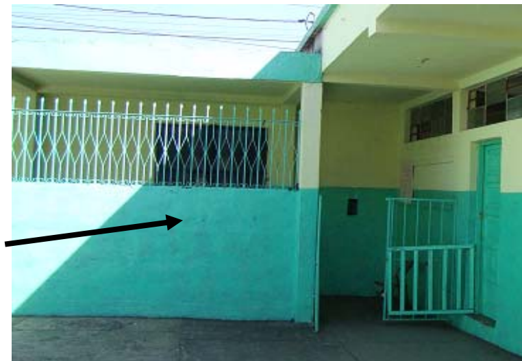
Pared que obstaculiza la salida del Colegio
