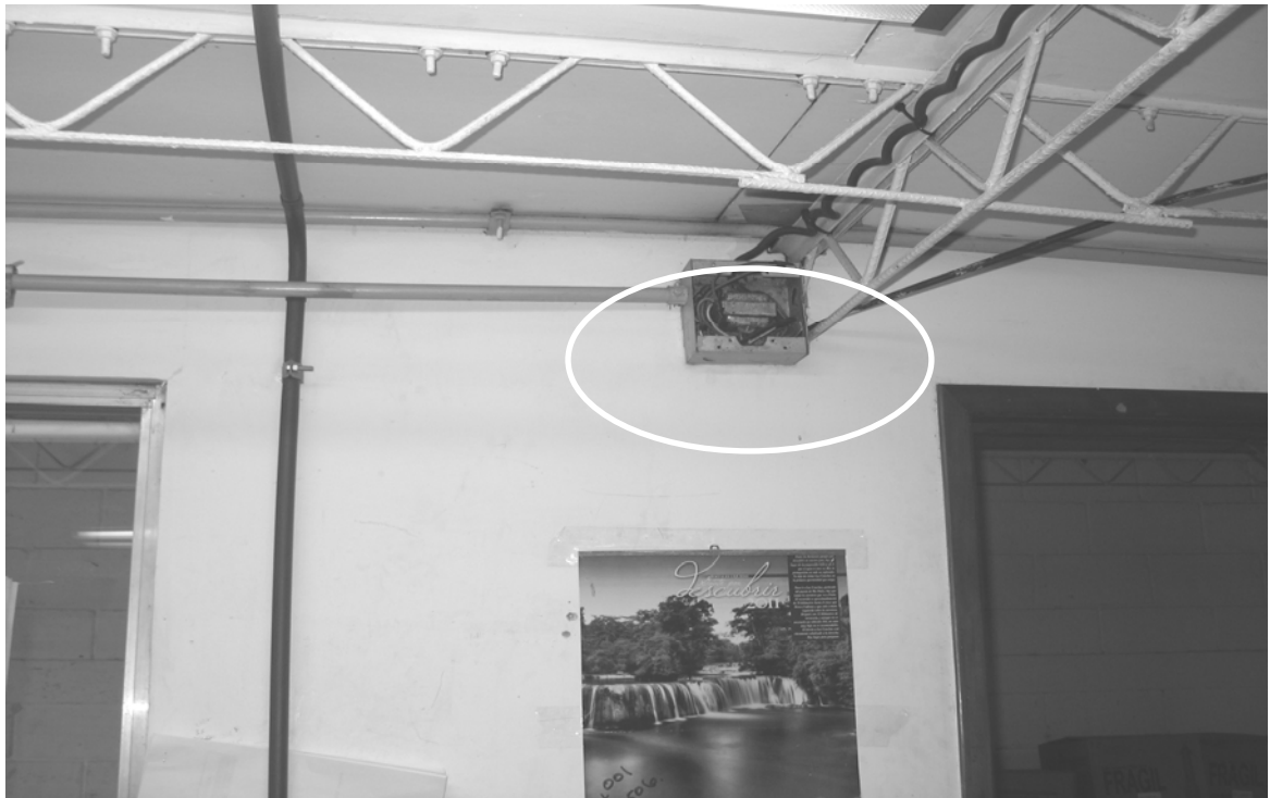
Situación instalaciones eléctricas área de almacenes
