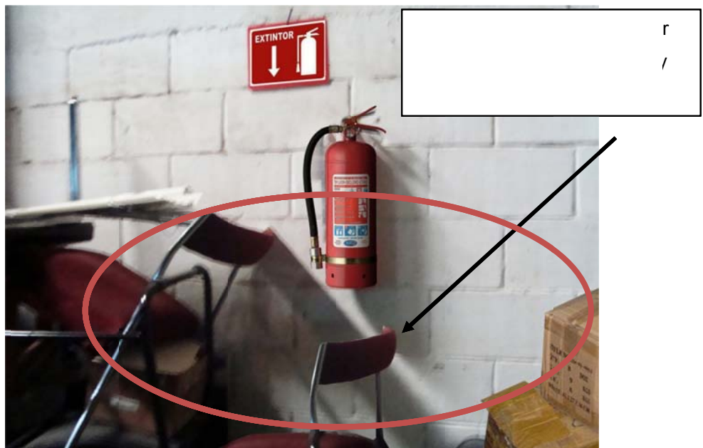
Imagen 5 Ubicación de extintores
