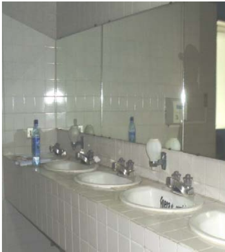
Imagen 50 Sanitarios de damas
