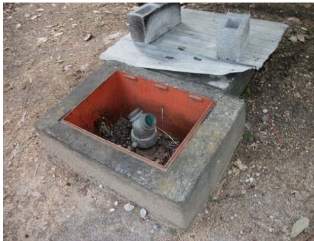
Imagen 25 Hidrante ubicado en el parqueo del personal
