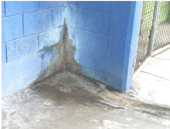
Imagen 58 Paredes del galpón 7, manchas y con mal aspecto
