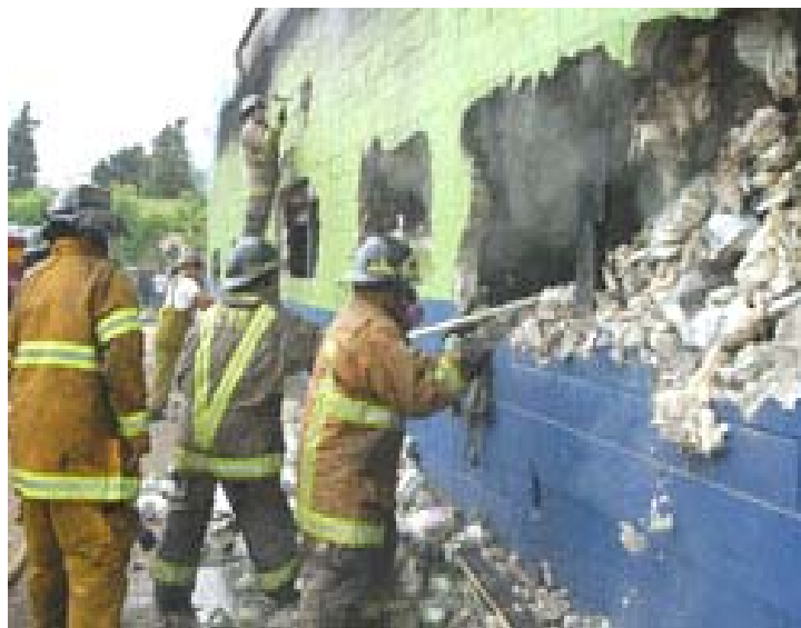
Imagen 26 Bomberos, abriendo boquetes en las paredes de los locales
