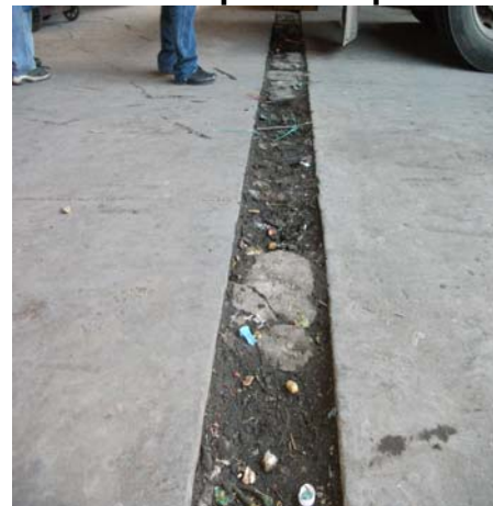
Imagen 20 Cuneta pluvial tapada
