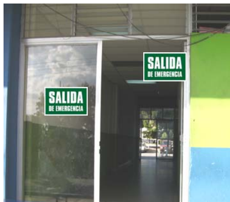
Imagen 74 Salidas de emergencia en el edificio administrativo
