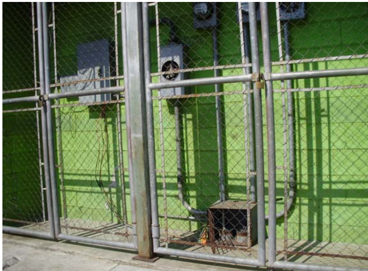
Imagen 15 Medidores eléctricos sin señalización de riesgo eléctrico
