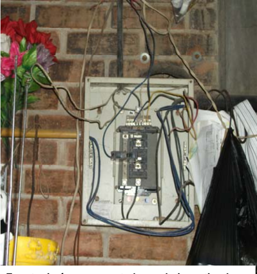
Imagen 35 Caja de flipones con cables expuestos
