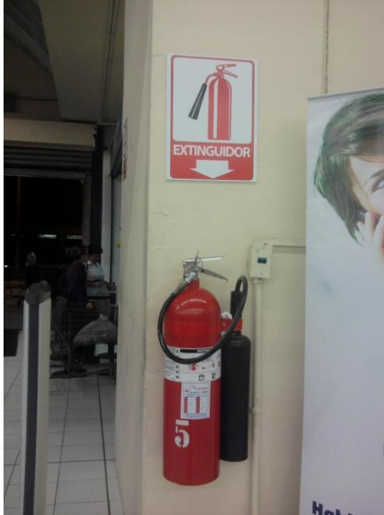
Fotografía 16 Colocación adecuada de un extintor
