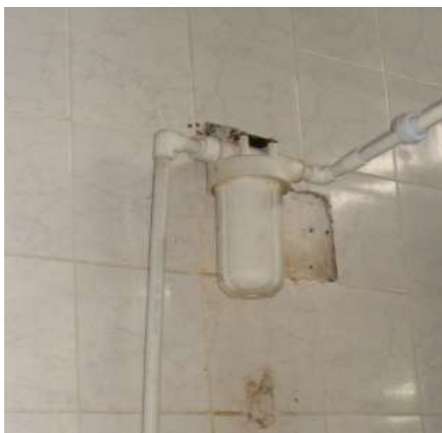
Fotografía No. 15 Pulidor 1 de planta purificadora Empresa de Agua Pura
