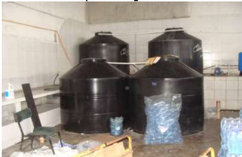
Fotografía No. 13 Tanques con agua sin purificar Empresa de Agua Pura
