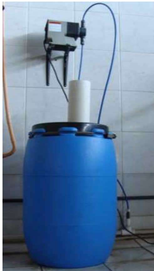
Fotografía No. 14 Tanque de cloro y dosificador Empresa de Agua Pura
