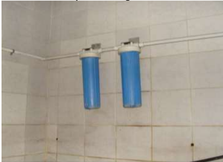
Fotografía No. 17 Pulidor 2 y 3 de planta purificadora Empresa de Agua Pura
