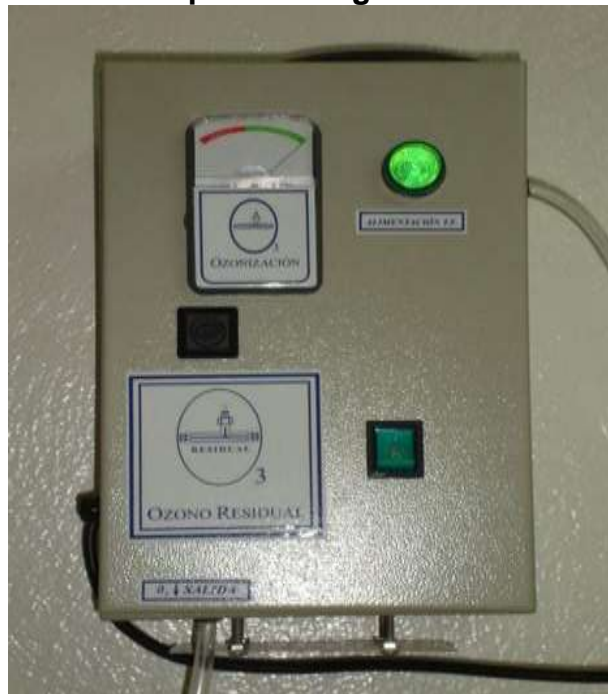
Fotografía No. 20 Generador de ozono de planta purificadora Empresa de Agua Pura
