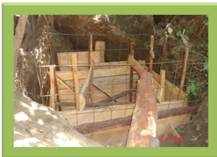
Fuente: UEDICH MAGA (Protección nacederos de agua). Año 2008.
