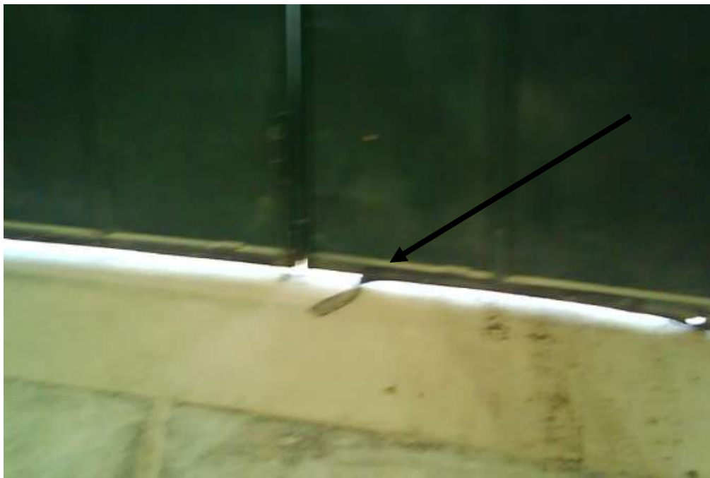
FOTOGRAFÍA 20 HULE DE PLÁSTICO FUERA DE LUGAR EN EL PORTÓN
