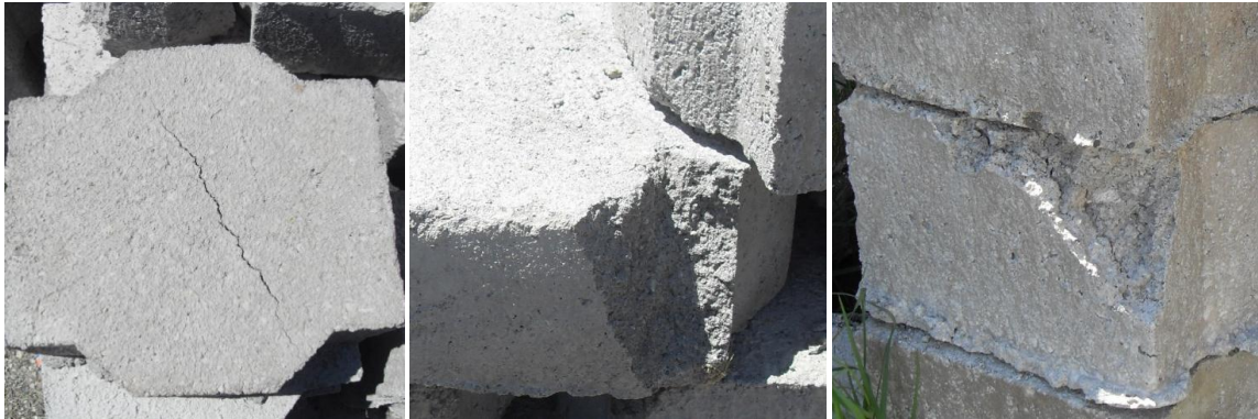
Consecuencias de un deficiente curado del adoquín.
