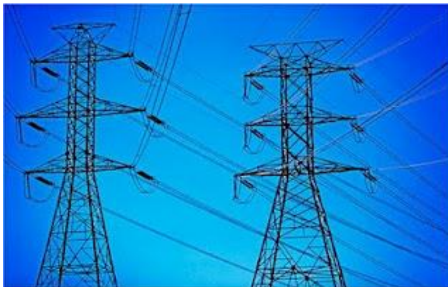
Fotografía 2 Torres de 230 KV
