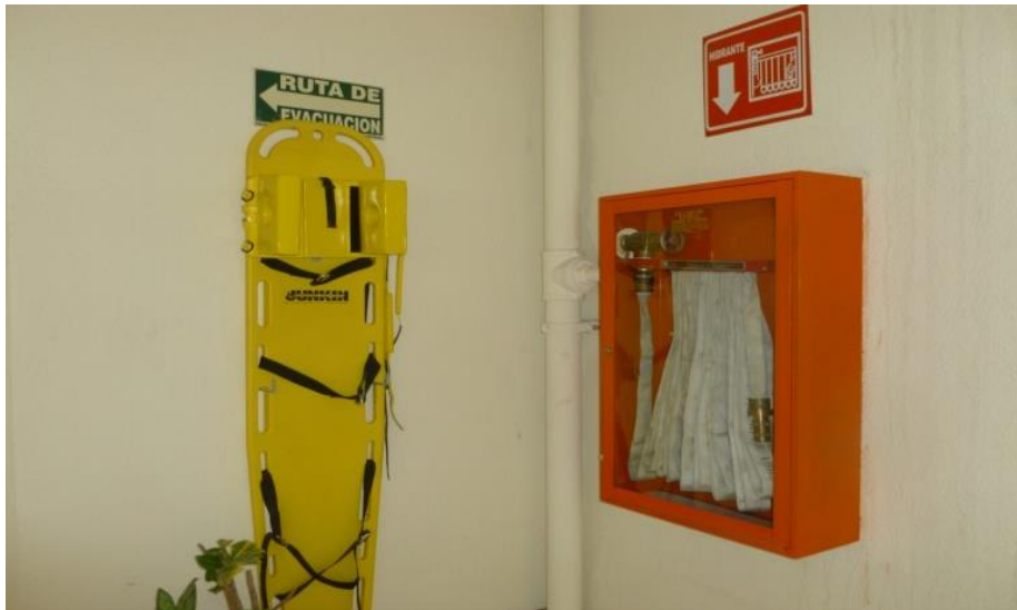
Fotografía 17 Manguera contra incendio
