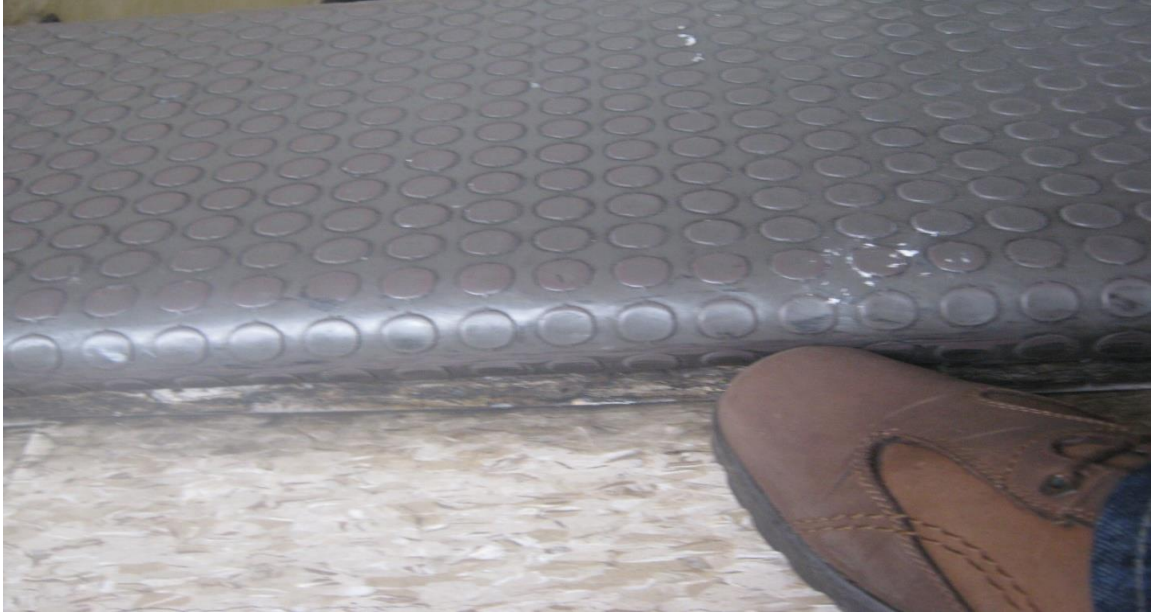
Imagen 22 Grada sobrepuesta al piso del tercer nivel
