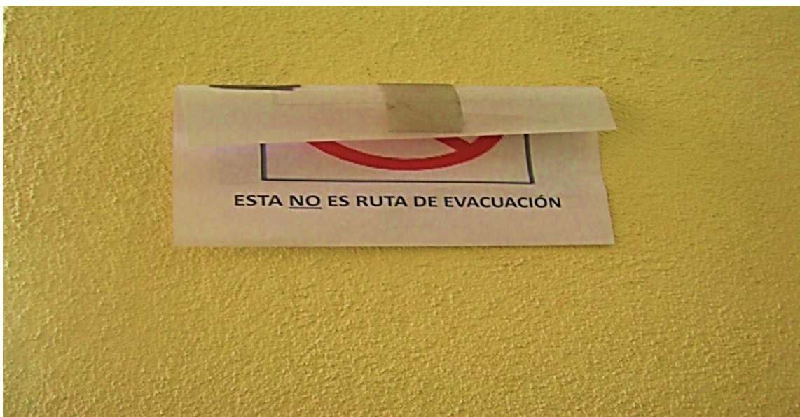
Imagen 53 Señalización elaborada con materiales inadecuados
