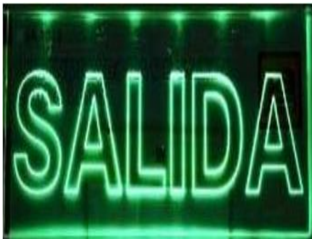
Imagen 96 Luces de emergencia con leyenda de salida
