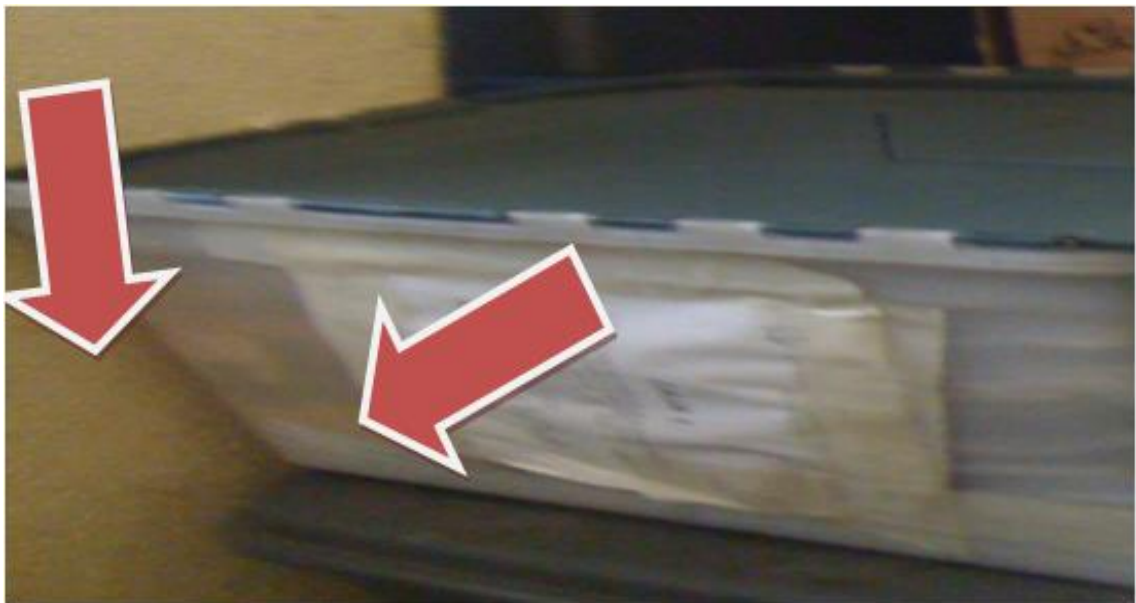
Imagen 46 Pared manchada por humedad
