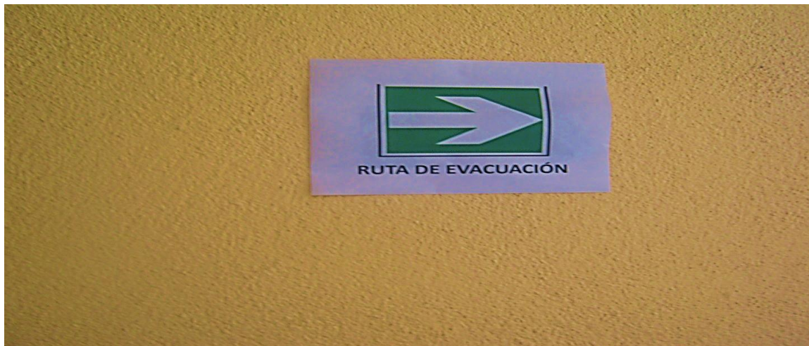
Imagen 52 Señalización del edificio, no tiene los componentes según la CONRED
