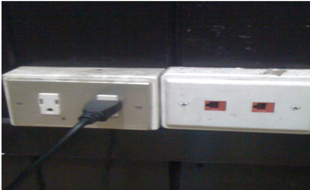
Imagen 29 Condiciones de los tomacorrientes y puntos de red
