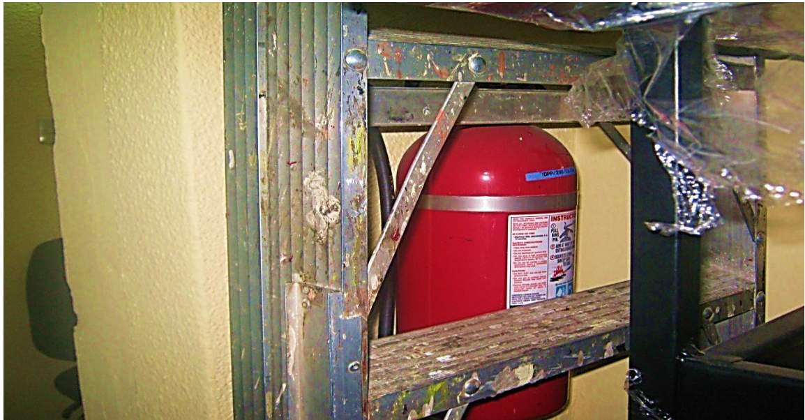
Imagen 24 Obstrucción de equipo contra incendios en el primer nivel
