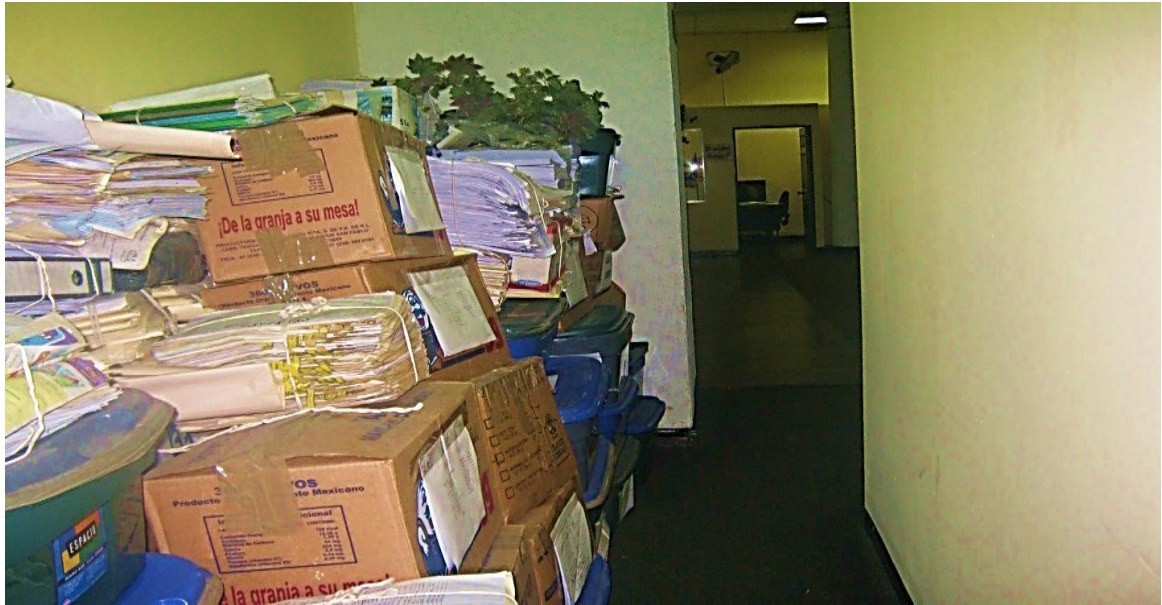
Imagen 47 Obstrucción en los pasillos del primer nivel
