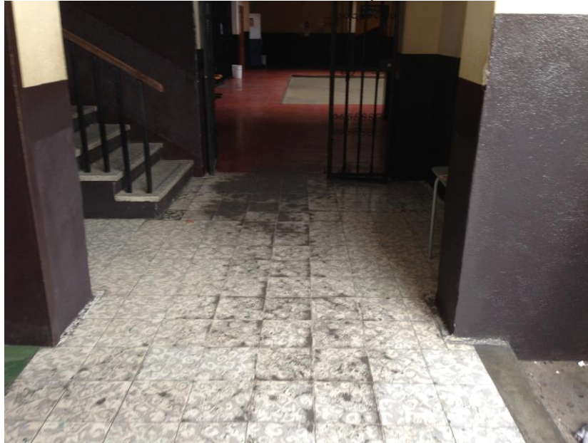
Imagen 12 Estado actual del piso
