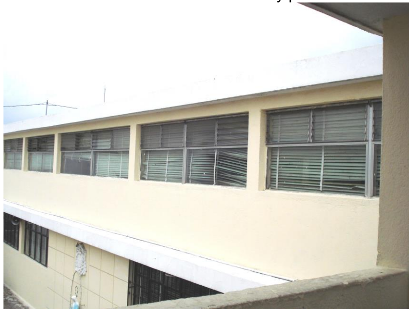
Imagen 8 Estado actual de las ventanas y persianas
