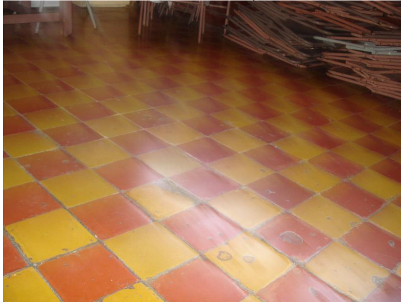
Imagen 10 Estado actual del piso
