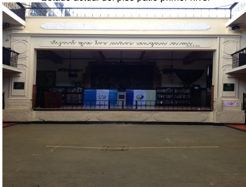
Imagen 11 Estado actual del piso patio primer nivel
