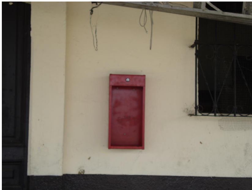
Imagen 17 Sitio del extintor vacío
