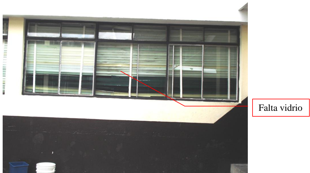
Imagen 9 Estado actual de las ventanas y persianas
