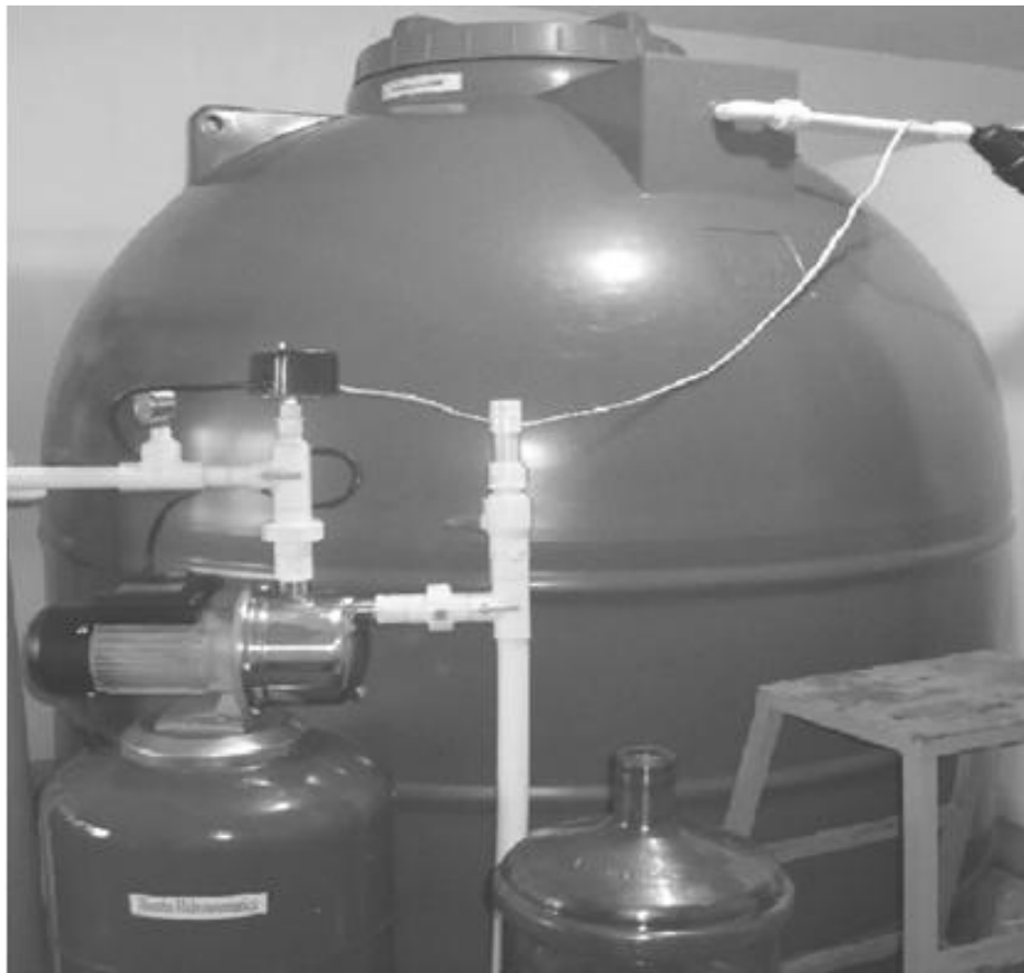
Imagen 21 Tanque de sedimentación
