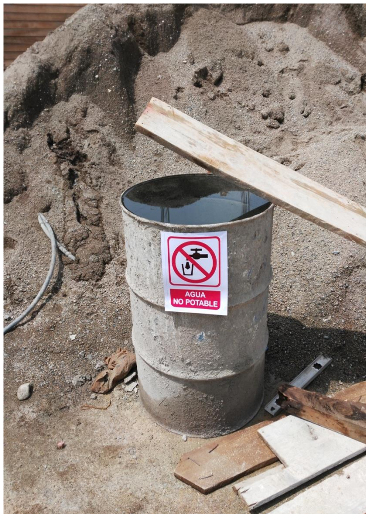
Imagen 46 Señalización de agua no potable
