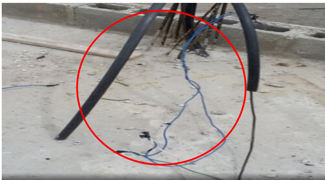
Imagen 19 Cable eléctrico en terraza sin protección
