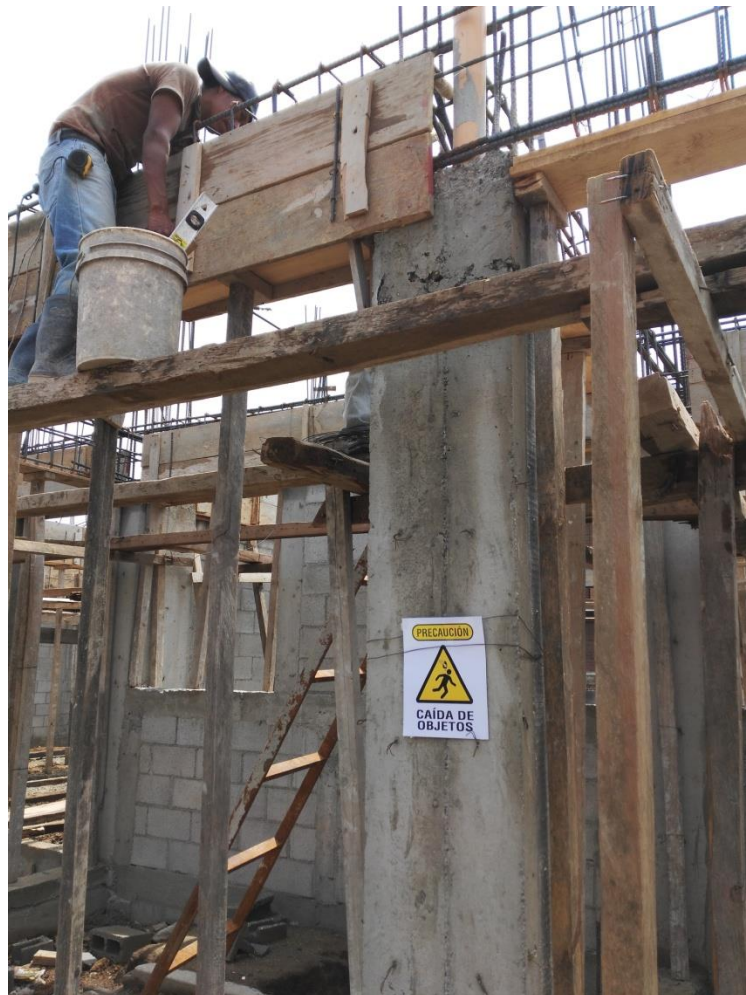
Imagen 49 Señalización peligro de caída de objetos
