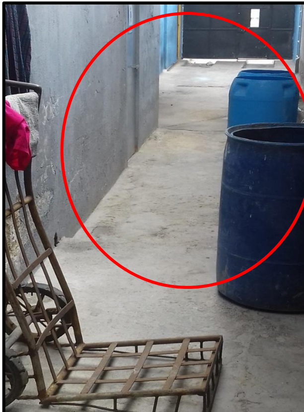
Pasillo del área de soda cáustica
