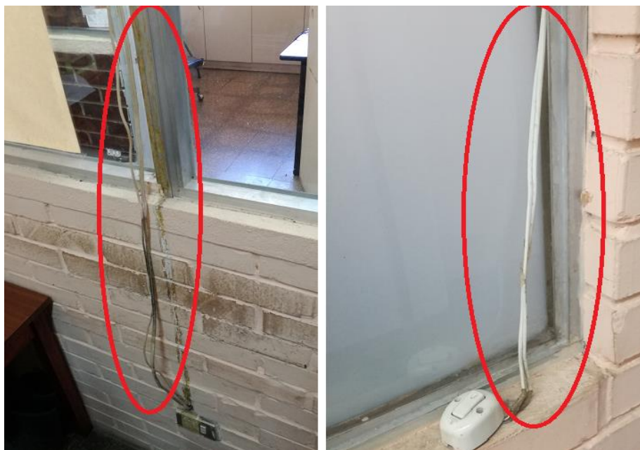
Imagen 19 Condición de cableado eléctrico, Facultad de Medicina Veterinaria y Zootecnia
