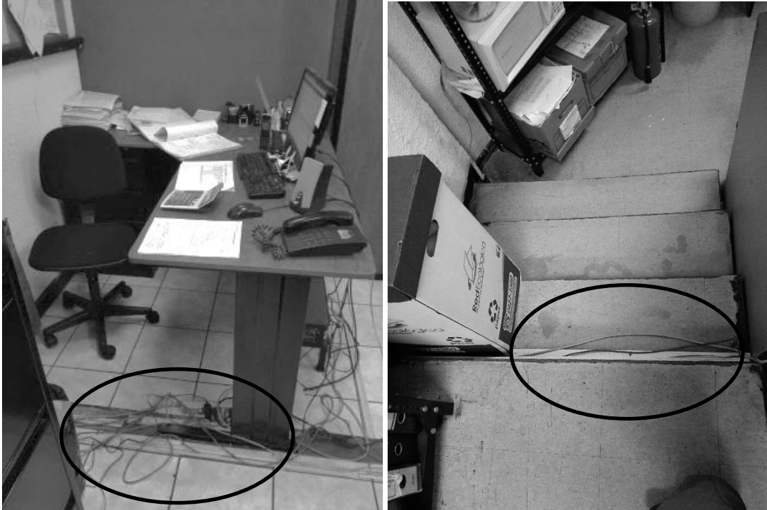
Imagen 51 Cables sueltos en áreas de trabajo
