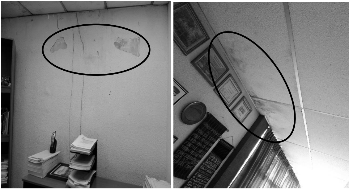
Imagen 50 Paredes en mal estado y filtración de agua
