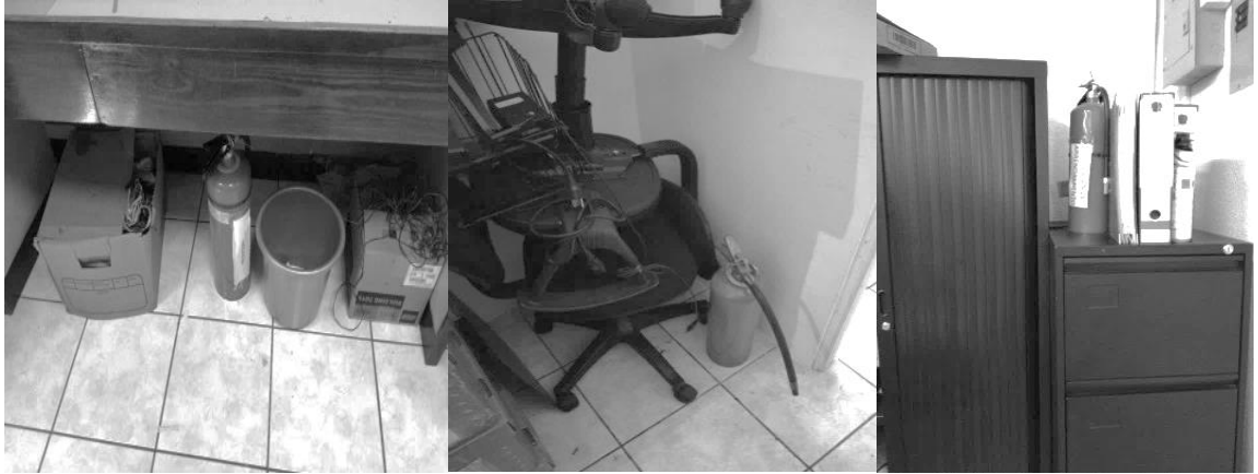
Imagen 46 Ubicación de extintores
