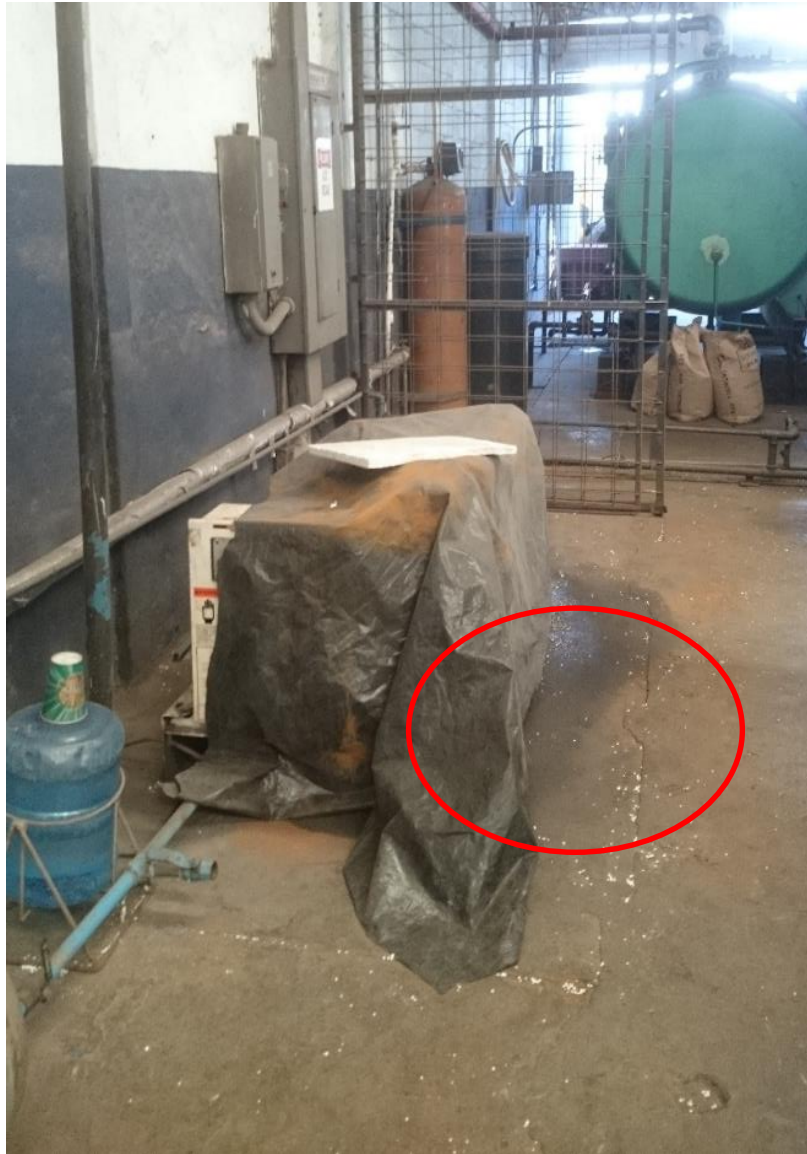
Imagen 6 Piso de área de caldera
