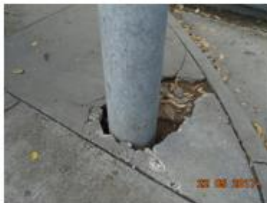
Fotografía No.1: La fotografía muestra la banqueta sin reparar.
