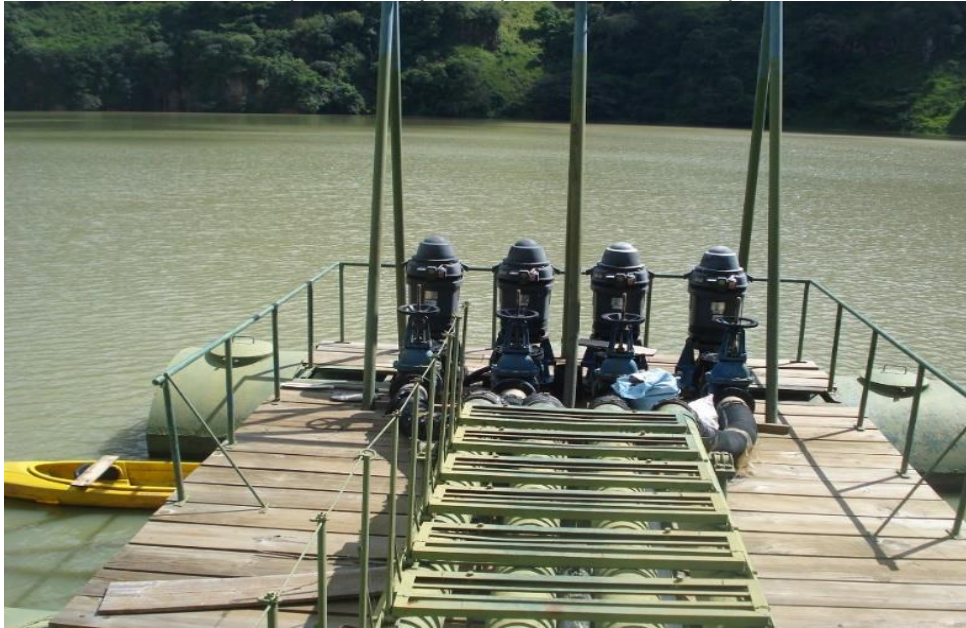
Figura 5 Turbinas de succión montadas sobre balsa. Laguna del Hoyo. Municipio de Monjas, departamento de Jalapa.
