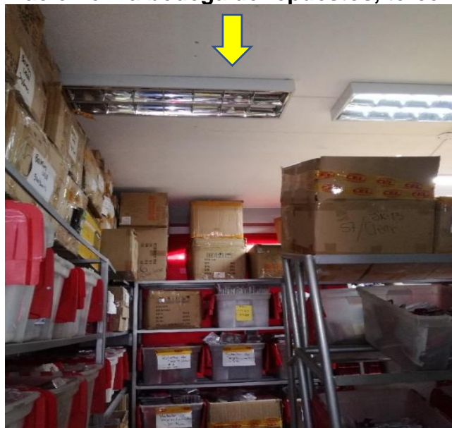
Imagen 37 Iluminación en la bodega de repuestos, tercer nivel
