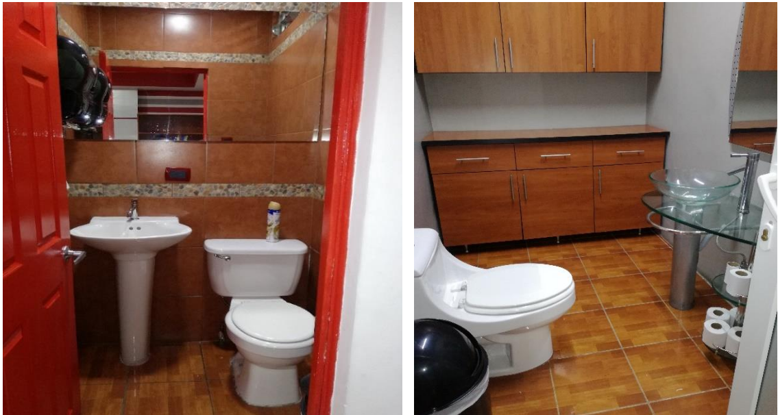
Imagen 39 Condiciones de los sanitarios
