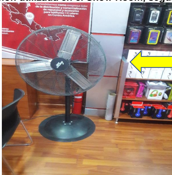
Imagen 30 Ventilación utilizada en el Show Room, segundo nivel
