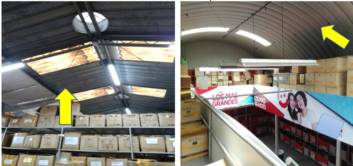
Imagen 44 Situación actual del techo, tercer nivel
