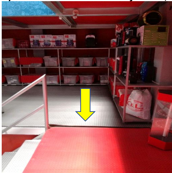
Imagen 42 Condición del piso en área de ventas a mayoristas, segundo nivel
