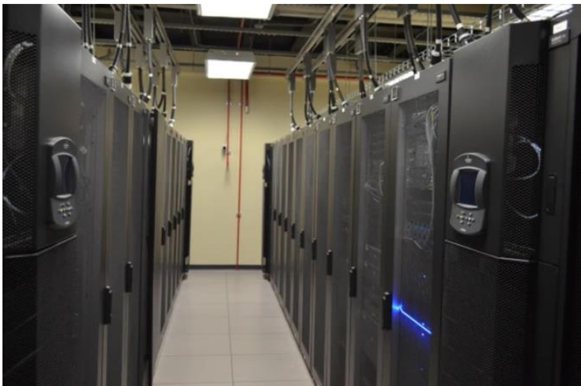
Figura 2 Centro de Datos y Gabinetes de GBM
