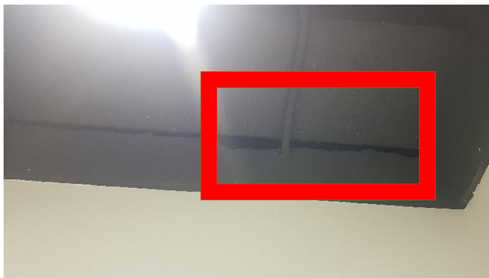
Imagen 26 Grietas en el techo
