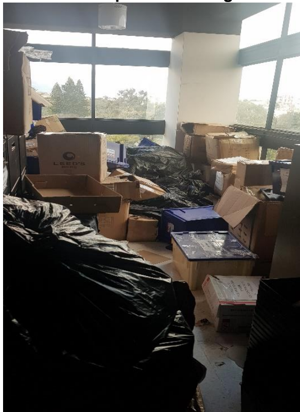
Imagen 65 Carencia de limpieza en bodega 6to nivel
