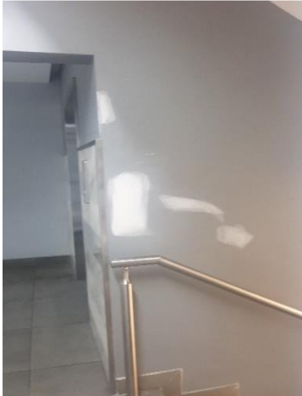
Imagen 68 Pared manchada en escaleras del segundo nivel
