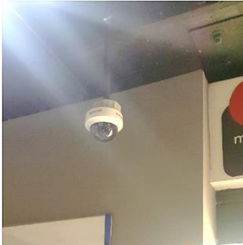
Imagen 35 Cámaras de vigilancia
