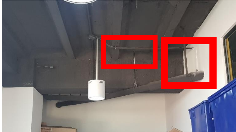
Imagen 25 Ausencia de limpieza en techo
