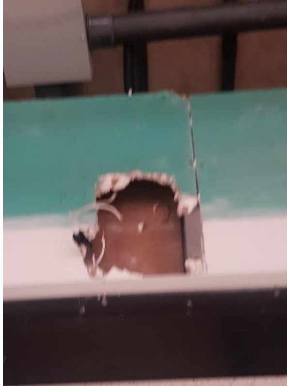
Imagen 24 Pared en mal estado en área de ventas
