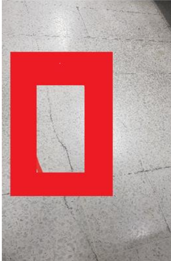
Imagen 23 Piso del área de ventas en mal estado
