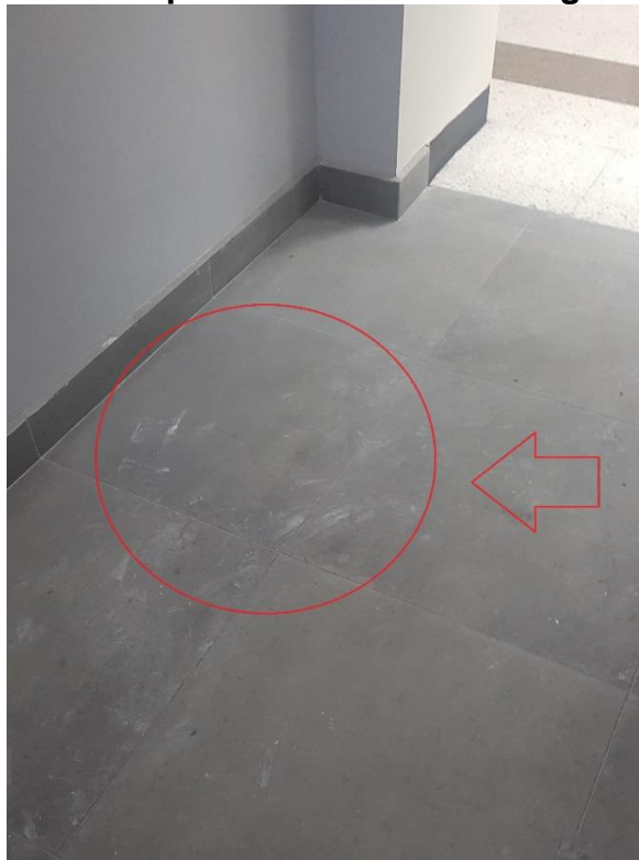
Imagen 67 Ausencia de limpieza en corredor de segundo nivel
