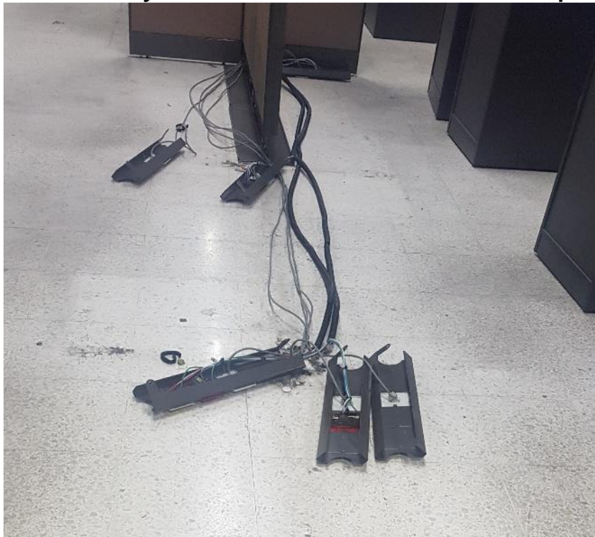
Imagen 40 Conexiones de red y cables de corriente eléctrica área de productos
